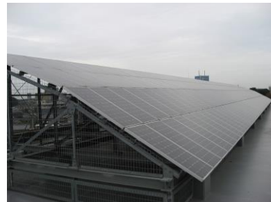
太陽光発電電池パネル
