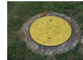
耐震性貯水槽
