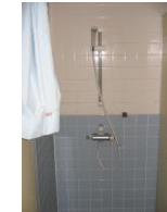
シャワー設備
